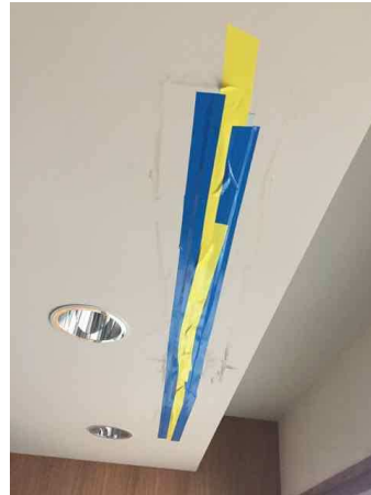
Bouche de ventilation obstruée
