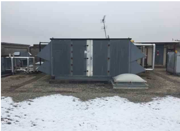
CTA en toiture du R+3 au R-1
