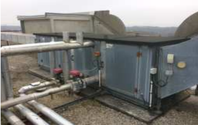
CTA en toiture
